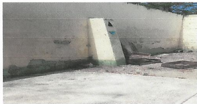
Foto3. Muro perimetral presenta problemas de humedad y salitre.
