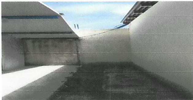
Foto 1. Área de cocina no cuenta con drenajes para salida de pluvial.
