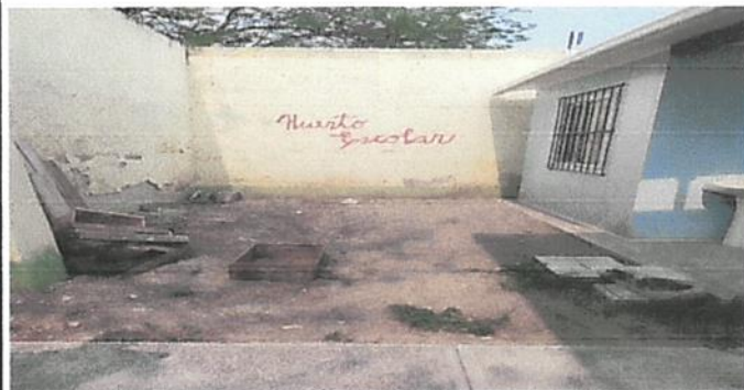
Foto 2. No cuenta con torta de cemento.
