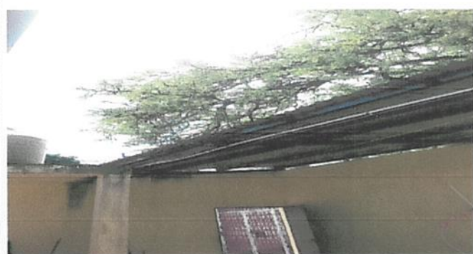
Foto 4. Terraza no cuenta con bajada de agua pluvial.
